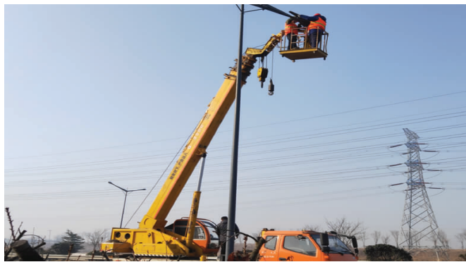
连日来，徐圩生产服务中心以“基层党组织+班组职工技能提升”为抓手，党员技术骨干施工小分队“战严寒、抢进度、树品牌、提技能”，全力推进外接500盏路灯维修业务工程，当前已完成188盏路灯维修任务。(胡可志)
